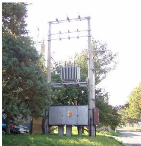
Sloupová TS s obchodním měřením
