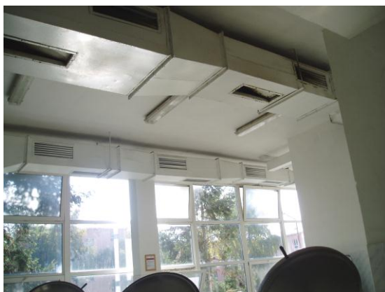
Obj. č. 33 Vzduchotechnika, odsávací potrubí
