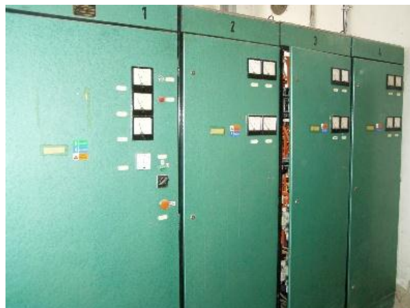
Hl. rozvodna nn - hl. rozvaděč OCEP
