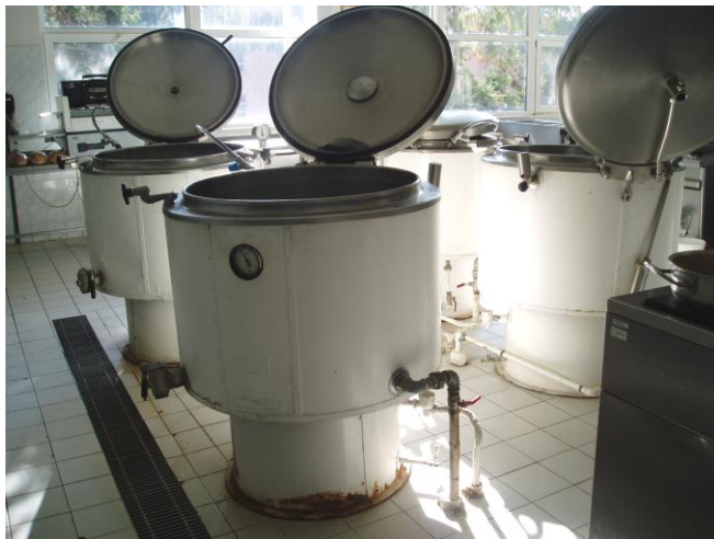
Varné parní kotle v kuchyni – obj. č. 33
