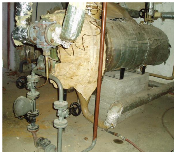
Výměník v objektu č. 06
