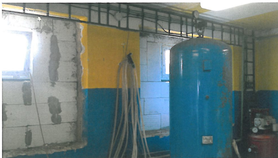
Obr. 2 Důsledek posunutí vyzdívky oproti původnímu umístění sklobetonu
