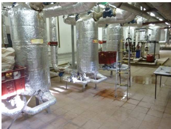
obrázek 4 Výměňkové stanice 006 a 033
