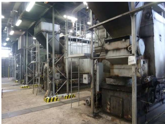
obrázek 3 Zdroj ÚT (vybavení předávací stanice)
