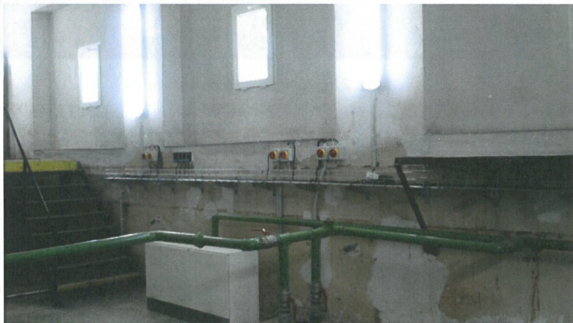
Obr. 1 Nový kabelový žlab
