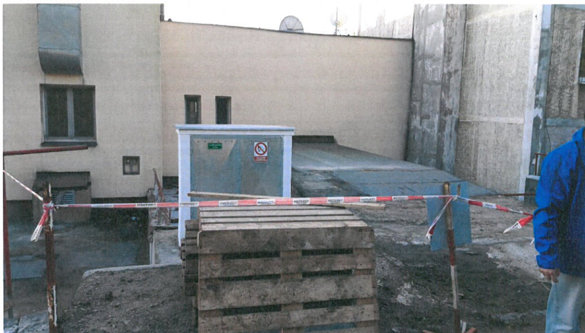
Pohled na HUP – shora - požadavek MO OSD na doplnění zábradlí
