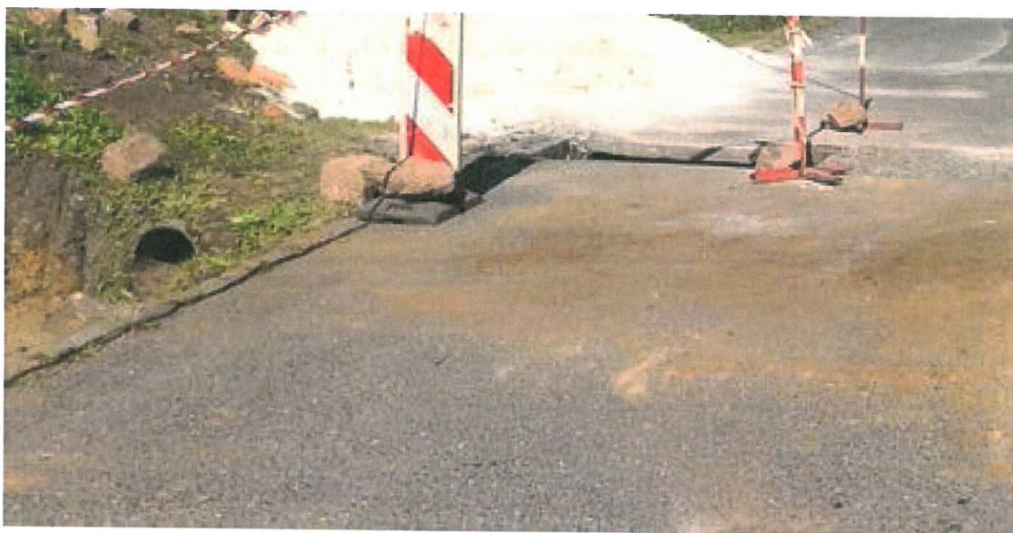
Pohled na stávající odvodňovací troubu – nedostatečné zapuštění stávajícího odvodnění
