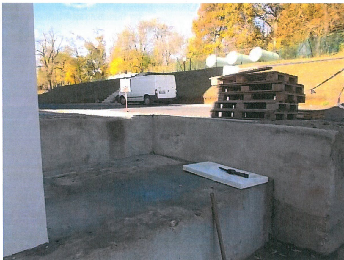
Pohled na „přístup“ k HUP - pohled zespoda - požadavek MO OSD na doplnění a zábradlí
